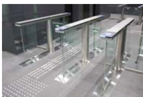
港南事業所のフラッパーゲート
