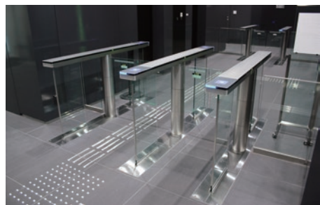
港南事業所のフラッパーゲート
