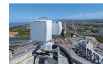
建物の屋上に設置された屋外型リモートカメラ「BU-43U」
