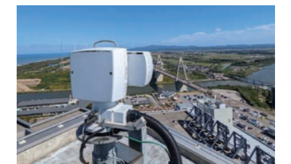
建物の屋上に設置された屋外型リモートカメラ「BU-43U」
