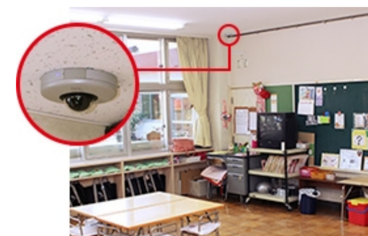
教室内に設置されたネットワークカメラ
