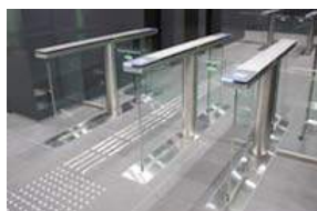
港南事業所のフラッパーゲート
